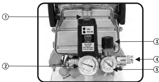
Fig. 12 - Acionamento do motocompressor
